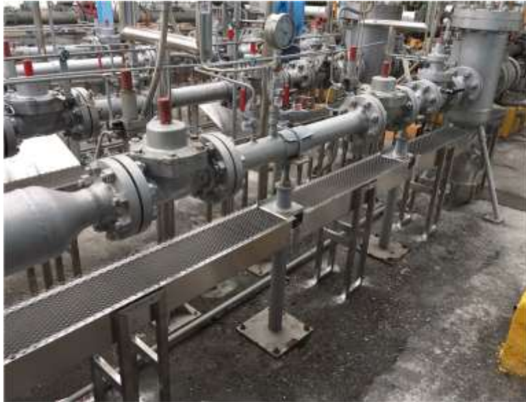
區域整壓站設置過濾器、超壓跳脫設備
